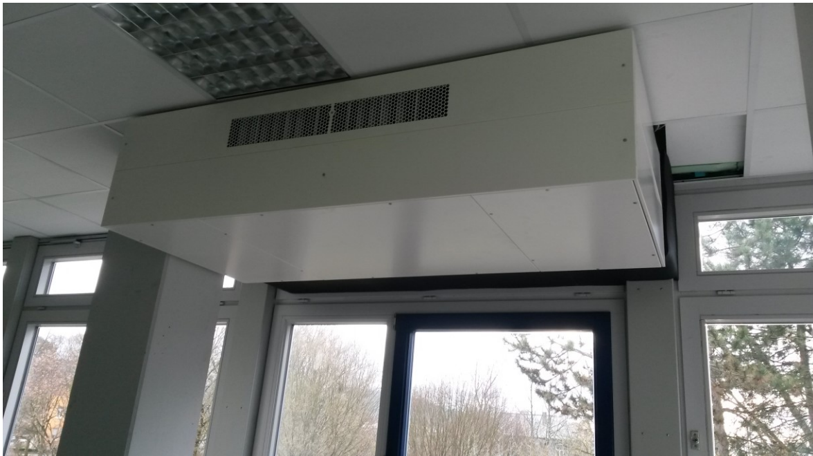
Kompaktlüftungsgerät in der THR
