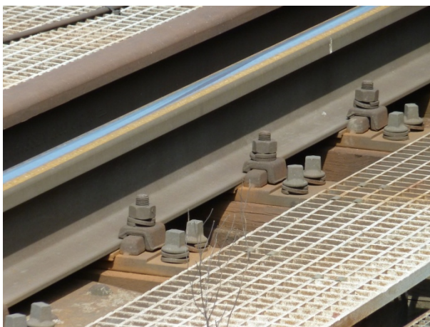
Abbildung 3: Schienenbefestigung auf der Brücke
