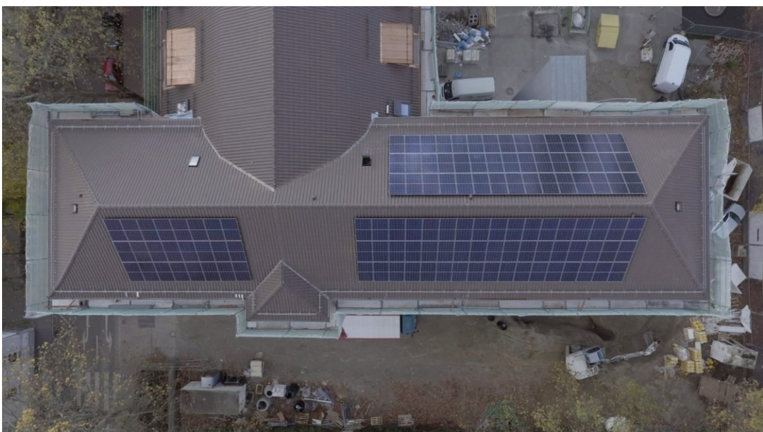
Dachaufsicht PV-Anlage Georg-Monsch-Schule
