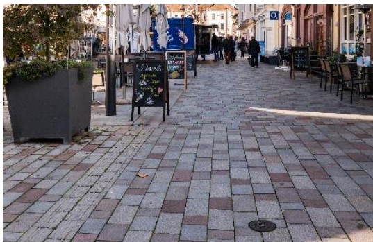
Abbildung 27: Kontrastloses Blindenleitsystem mit Hindernissen
