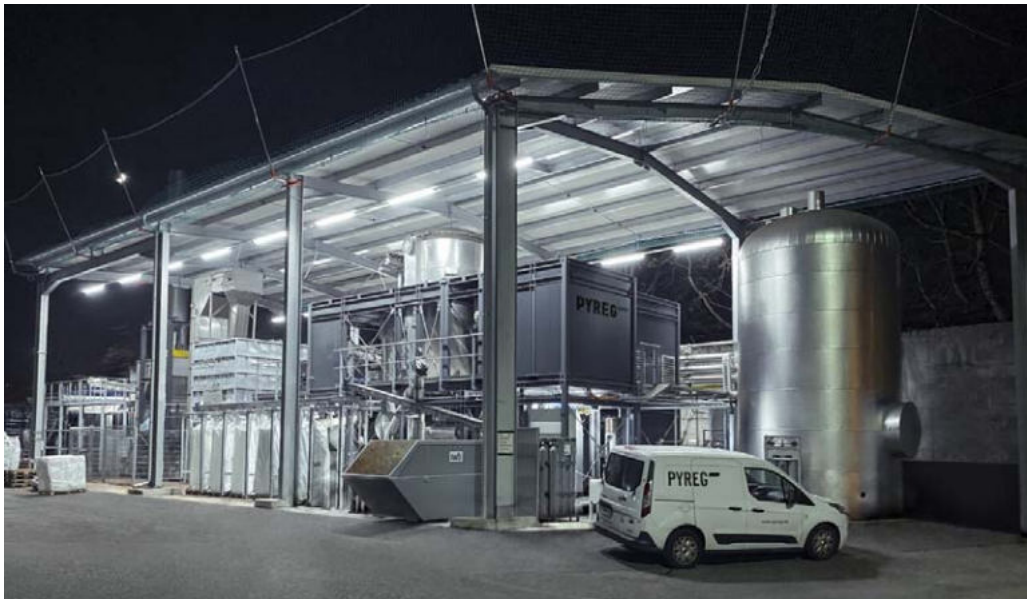
Abbildung 30: PYREG-Anlage zur Grünschnittpyrolyse in Basel (PYREG, 2022)
