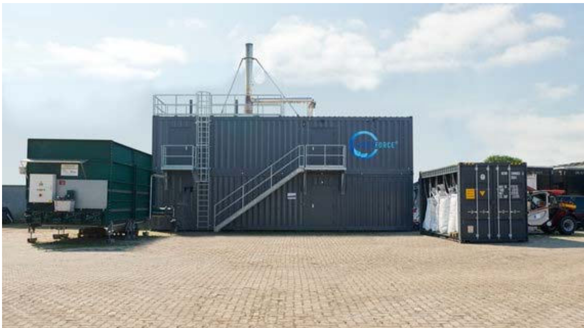
Abbildung 28: Pyrolyseanlage auf dem Hof der Abfallwirtschaft Rendsburg-Eckernförde (Abfall-Wertstoff-Ressource, AWR) in Borgstedt (Carbo-FORCE GmbH, o. D.)
