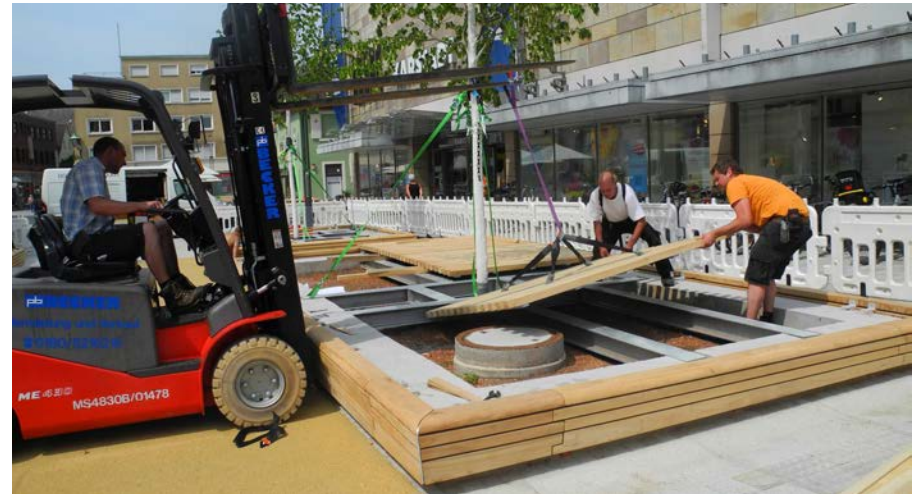
Abb. 12: Geringer Abstand zu einem Mischwasserkanal und Schacht auf dem Lindenplatz vermutlich nur durch entsprechenden Leitungsschutz umgesetzt
