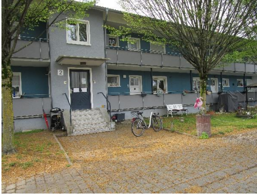
Fehlende Barrierefreiheit Eingangsbereiche
