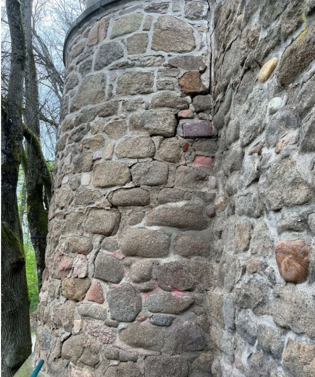
Bild 1 – Riss in der Turmwand
