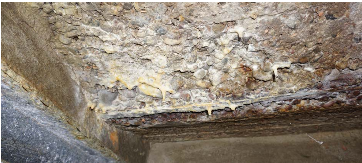
Bild 5 – Schädigung der Kappendecke mit Kalkausblühungen
