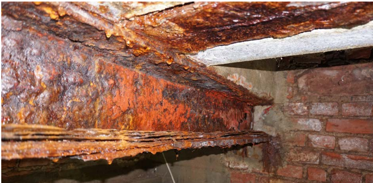
Bild 3 – Korrosionsschäden an einem der tragendem Stahlträger
