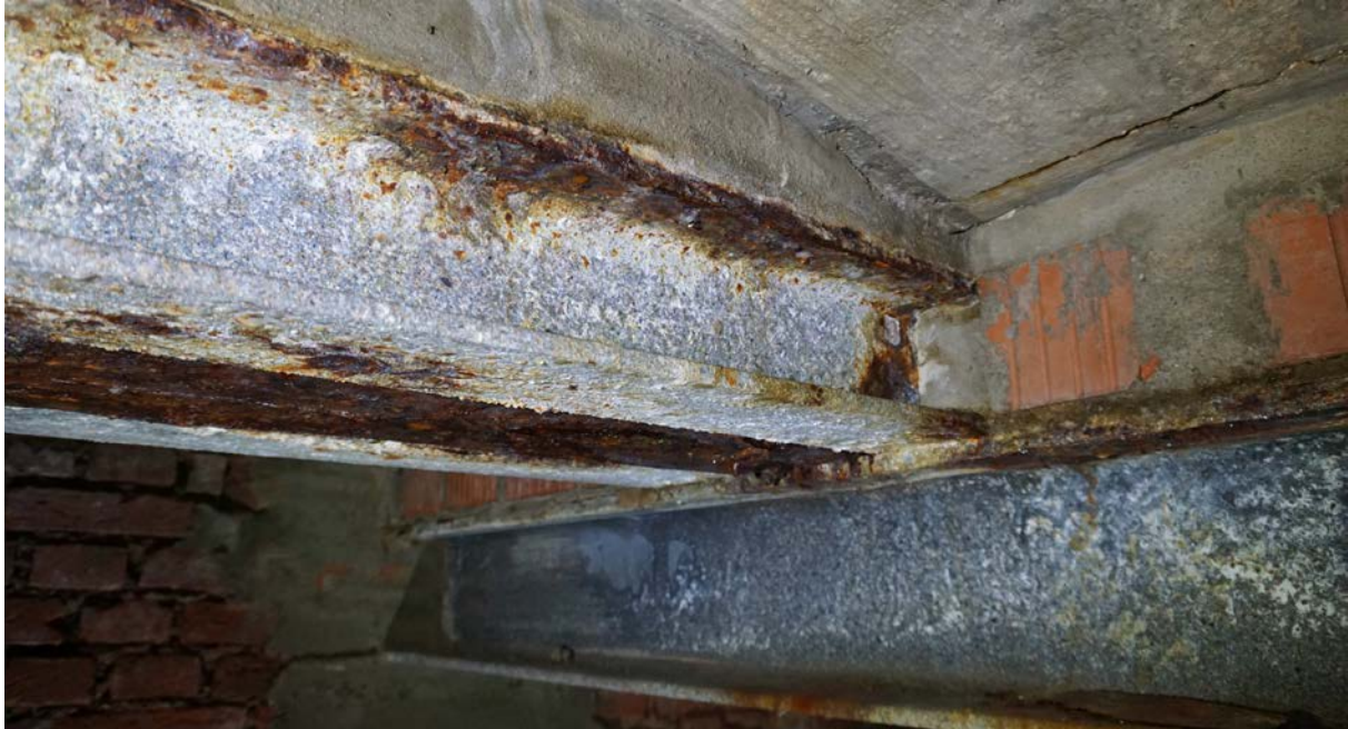
Bild 4 – Korrosionsschäden an feuerverzinkten Stahlträgern der Kappendecke
